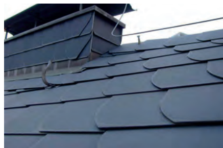
Beispiel 4: Dacheindeckung aus kleinformatigen Asbestzementplatten (Erneuerung der Dacheindeckung im Rahmen der Dämmarbeiten)
